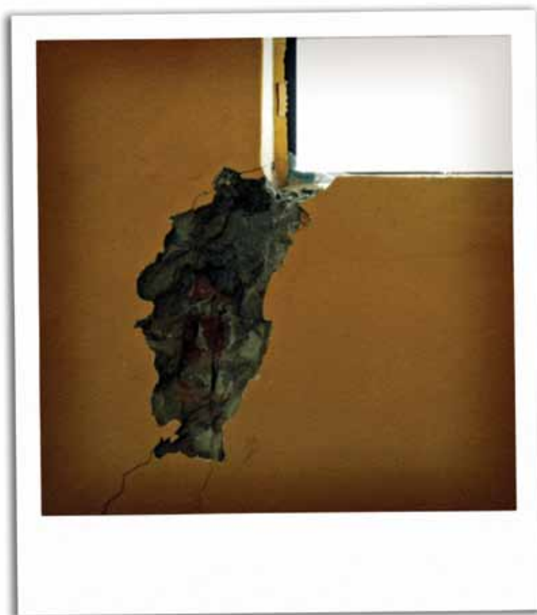
Condiciones de riesgo en instituciones educativas por mal estado de sus instalaciones físicas
